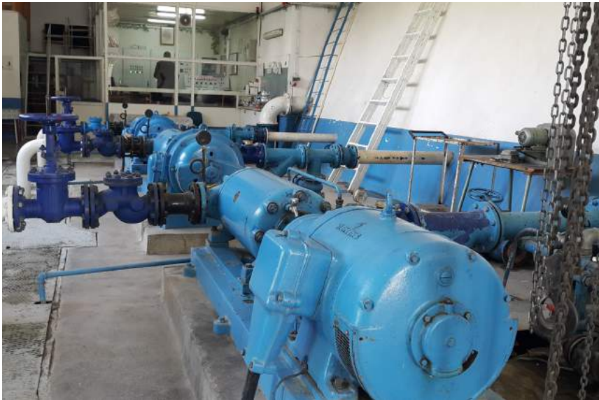
Eymir Gölü Pompa İstasyonu
